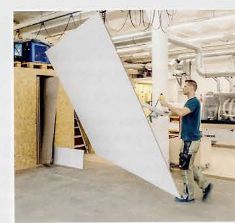
Der schwenkbare Vakuumheber verbindet das Plattenlager mit der Nesting-CNC
